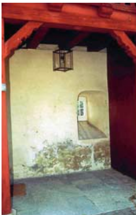
Die Ausblühungen in dieser Nische sind durch aufsteigende Feuchtigkeit entstanden.
