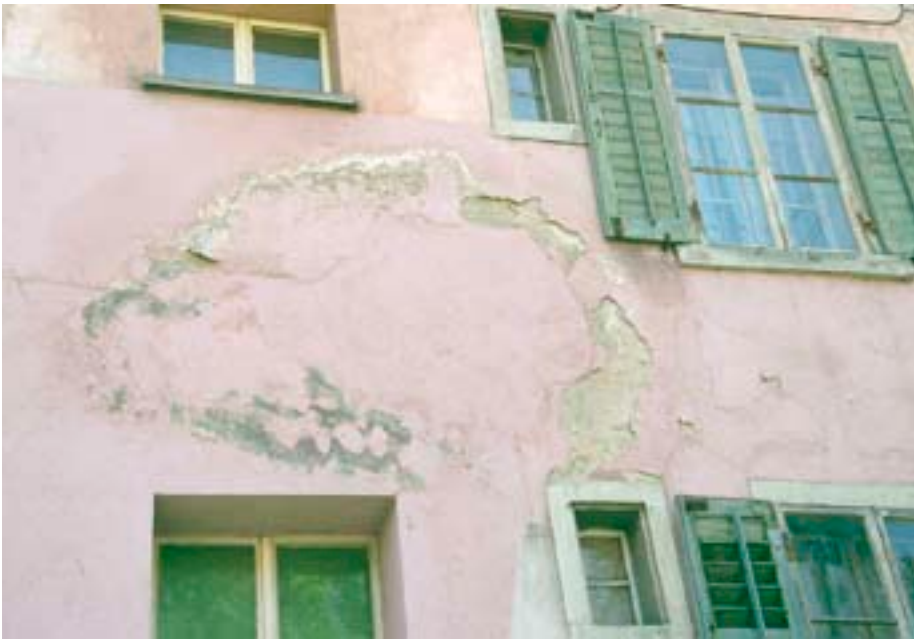
Ausblühungen nach einem Wasserschaden.
